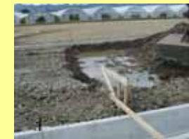
流用土と建設発生土(泥土相当) 層間に、水が溜まっている状況
